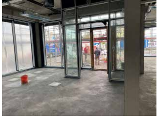
Se ha colocado el solado en toda la planta baja. Las habitaciones son cada vez más, lo que da una idea del aspecto que tendrán más adelante.
