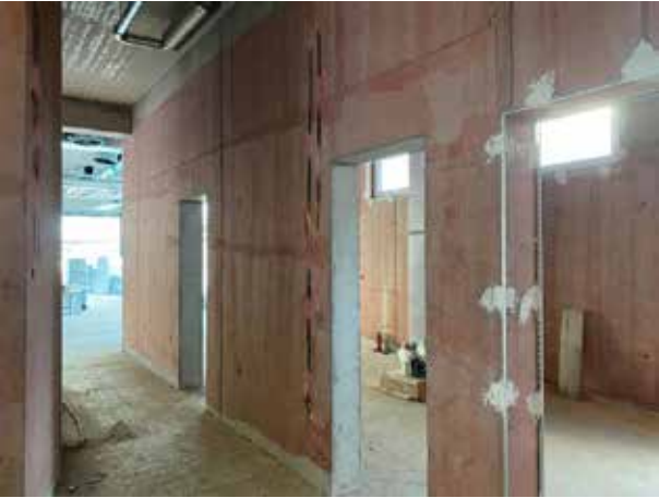
También se han imprimado ya todos los muros de hormigón de la planta baja.
