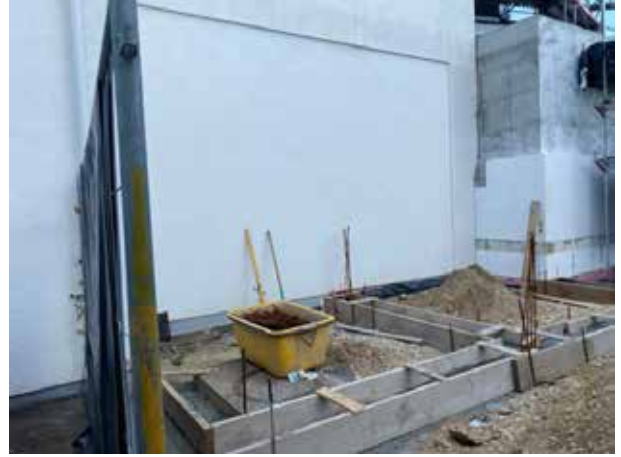
Detrás del edificio, se está construyendo un pequeño anexo como almacén de contenedores de basura, así como un cuarto separado para herramientas de jardinería, etc.
