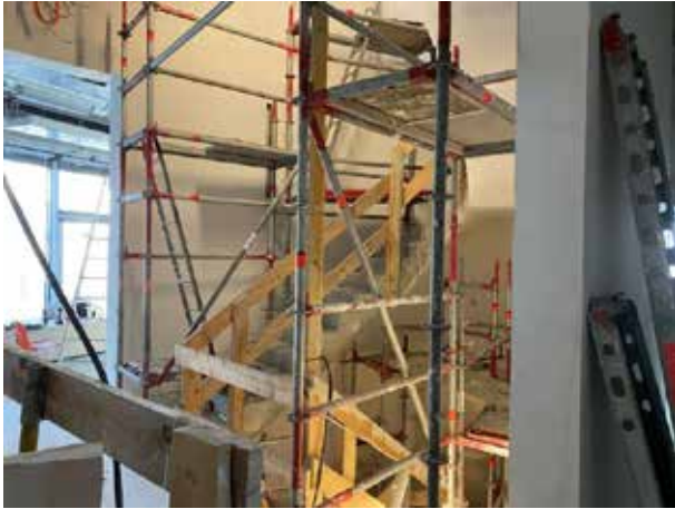
El hueco de la escalera está temporalmente intransitable, ya que se han montado andamios para el enlucido.
