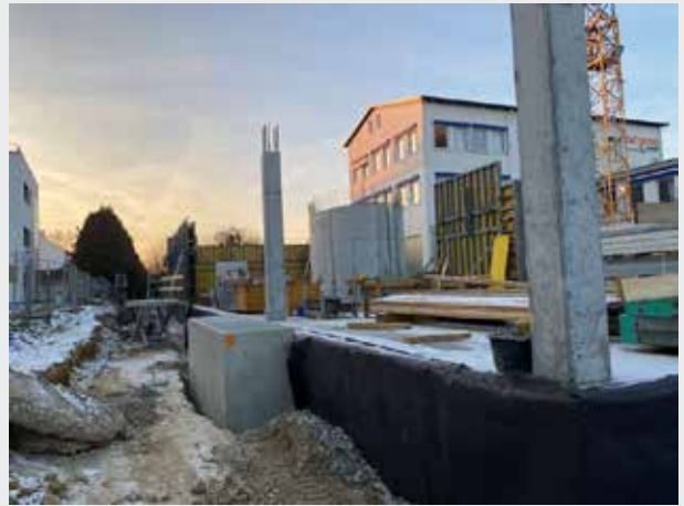
Vista desde el exterior a la zona de formación y conferencias. Aquí no se hormigonarán muros exteriores, sino que solo habrá columnas de hormigón, entre las que paredes de cristal proporcionarán una sensación de amplitud.
