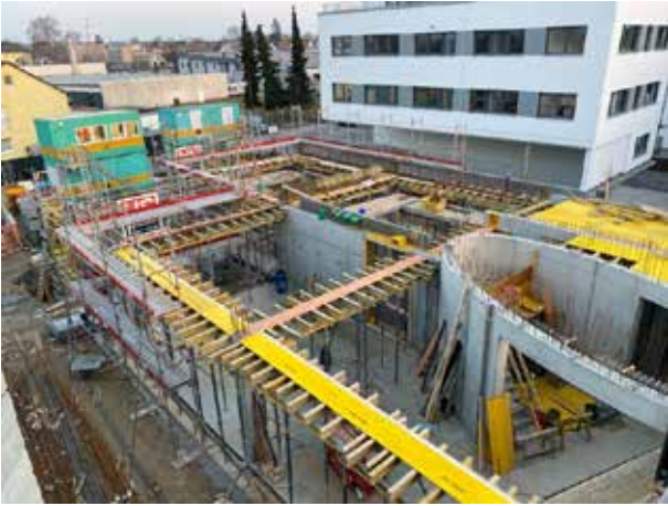
Se están encofrando las vigas del forjado de la zona de lantera.
