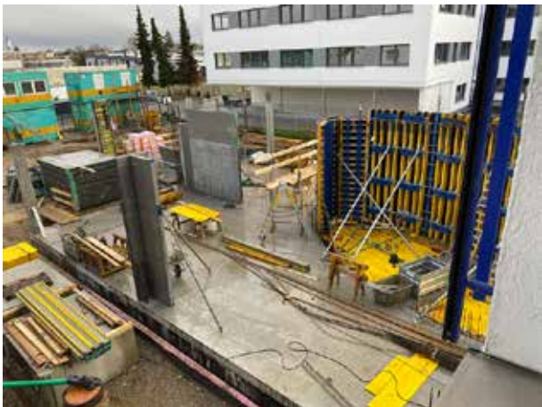
Las primeras columnas del amplio salón de actos ya están colocadas (parte superior, a la izquierda).
