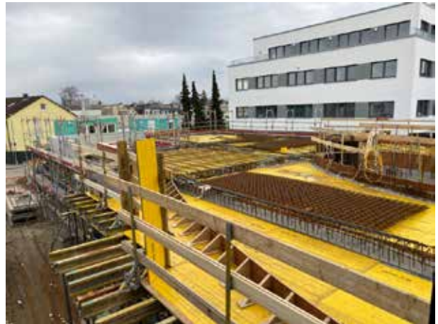
Aquí ya se puede ver la elipse que determina la forma del primer y segundo piso.
