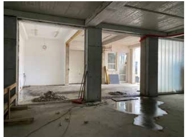
La conexión del nuevo almacén con el edificio antiguo está abierta, salvo por un antiguo elemento de pared que aún hay que retirar. Después, aún hay que romper el antiguo pavimento de alquitrán y crear un nuevo forjado.
