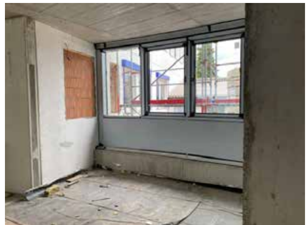
La fachada de la ampliación está ahora perfecta y estrechamente unida al edificio existente.
