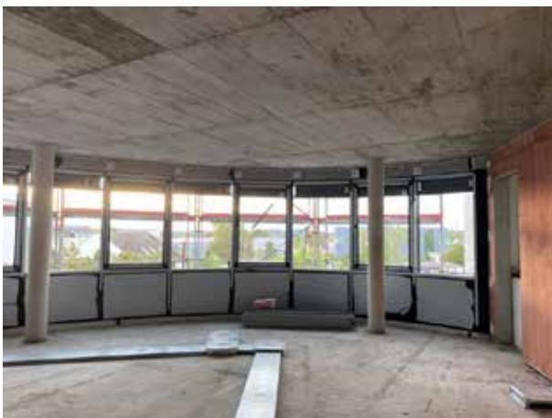
Las cajas de enchufes cuadradas dan una idea aproximada de dónde se colocarán los escritorios más adelante. Puedes ver las persianas instaladas en el exterior de las ventanas.
