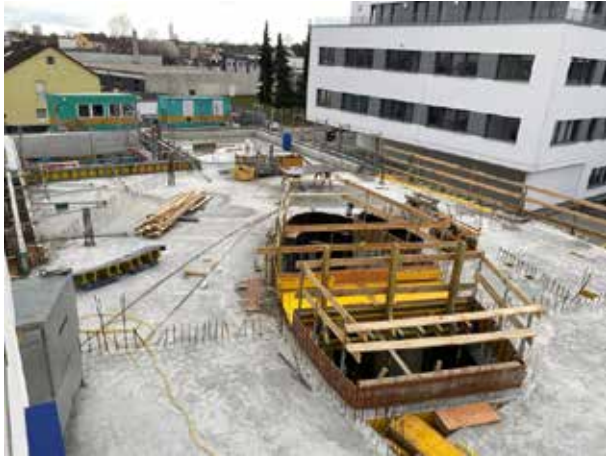
Ya están trabajando de nuevo en el encofrado de la elipse de la escalera . Lo primero que hacen es el "puente".
