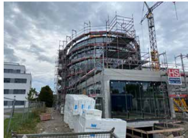
Parte de la fachada aún está cubierta con una película protectora, pero cada vez se puede adivinar mejor el aspecto que tendrá algún día.
