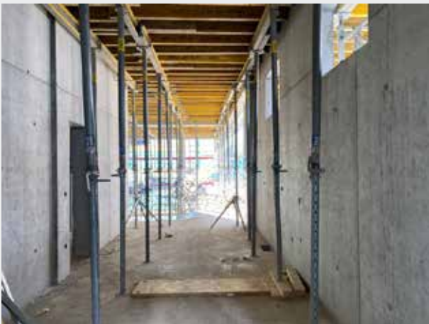
Vista desde la parte trasera de la zona de formación y conferencias.
