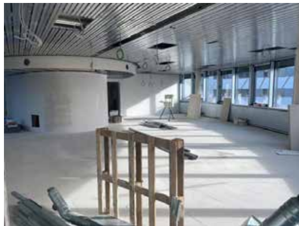
Y ahora todo está revestido. También se ha instalado el techo de calefacción y refrigeración. La oficina va tomando forma.
