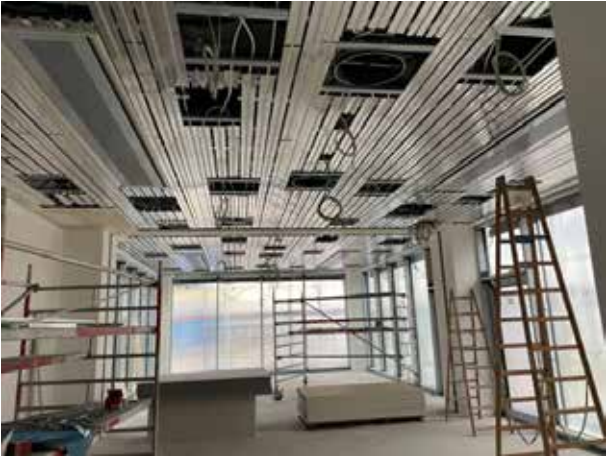
El techo de calefacción y refrigeración y las unidades de ventilación están instalados en la sala multifuncional.
