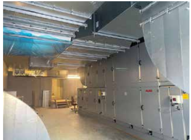
El sótano de ventilación está ahora lleno de la planta y los conductos de ventilación
