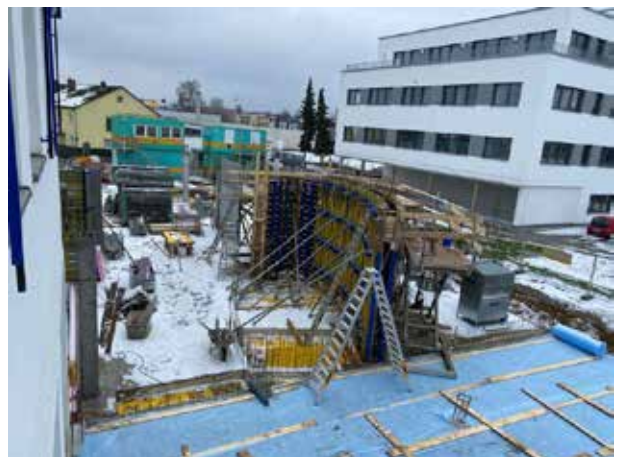
El invierno ha vuelto a Baviera. Sin embargo, siguen dando forma a la escalera y el 20 de enero incluso hormigonan el encofrado terminado.
