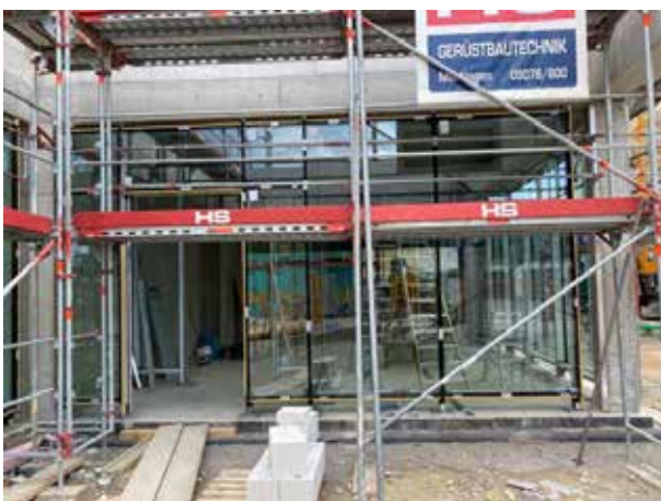
Los cristales se están instalando en la planta baja. Un día será la entrada principal.
