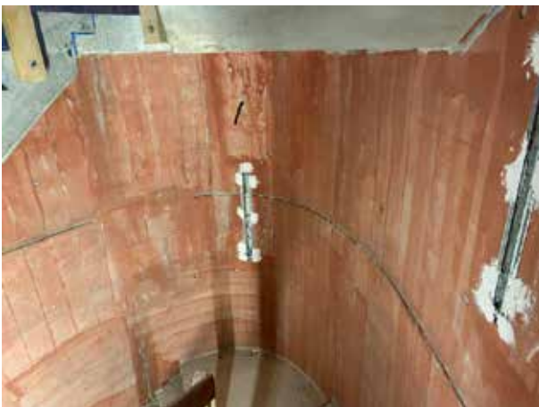
El hueco de la escalera aún está pendiente de enlucir. Hasta ahora sólo se ha imprimado.
