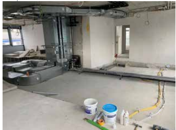
En la zona delantera, los conductos de ventilación aún tienen que desaparecer bajo el suelo.
