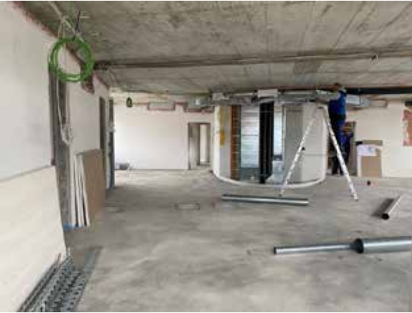
También se ha colocado la solera en la 2ª planta. Las tuberías del sistema de calefacción/refrigeración discurren por el techo.
