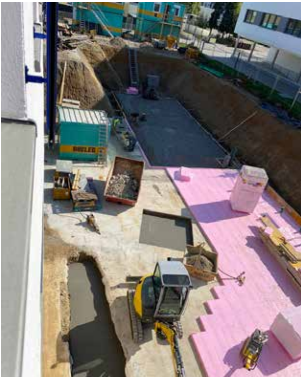
Ya se puede ver en el centro el foso rectangular para el futuro ascensor DICTATOR DHE. 200 mm de profundidad son suficientes.
