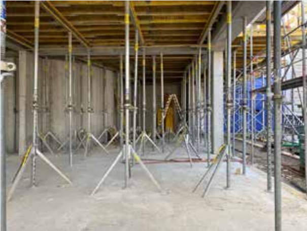
La futura entrada y zona de exposición. La (futura) fachada acristalada de la derecha deja pasar mucha luz.
