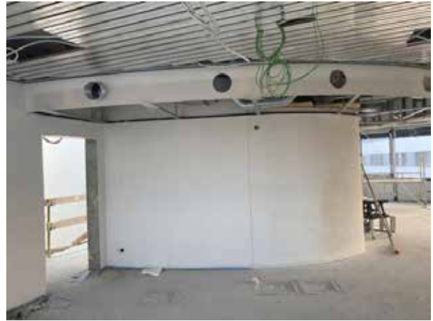
Los orificios del revestimiento superior son para las salidas de aire del sistema de ventilación.
