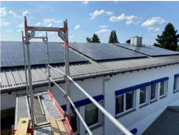
El sistema fotovoltaico de nuestro edificio actual. En los soleados y largos días de finales de mayo de 2023, somos autosuficientes en el suministro de energía, e incluso suministramos electricidad a la red.
