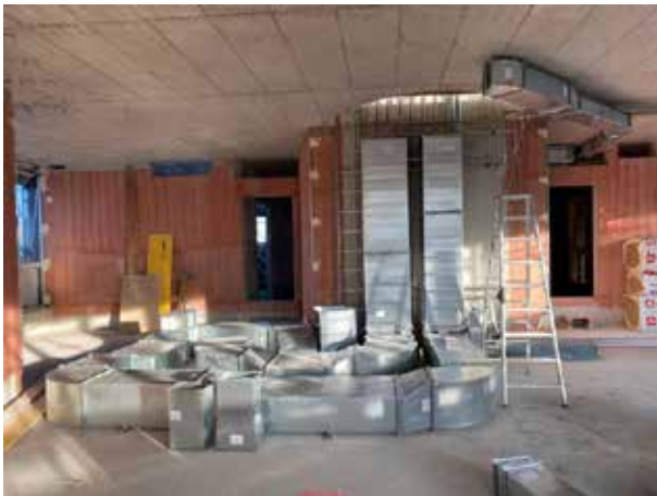
Algunos de los conductos de ventilación pasan por debajo del falso suelo. Esperemos que los instaladores estén familiarizados con este laberinto de conductos.
